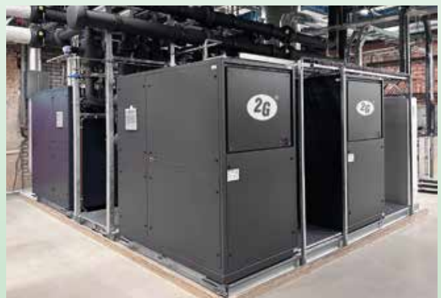
Pompe di calore
