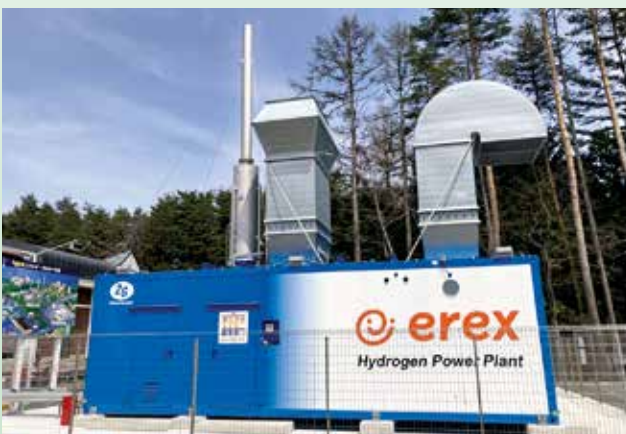
Cogenerazione a idrogeno
