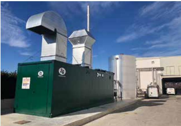
Cogenerazione a gas naturale
