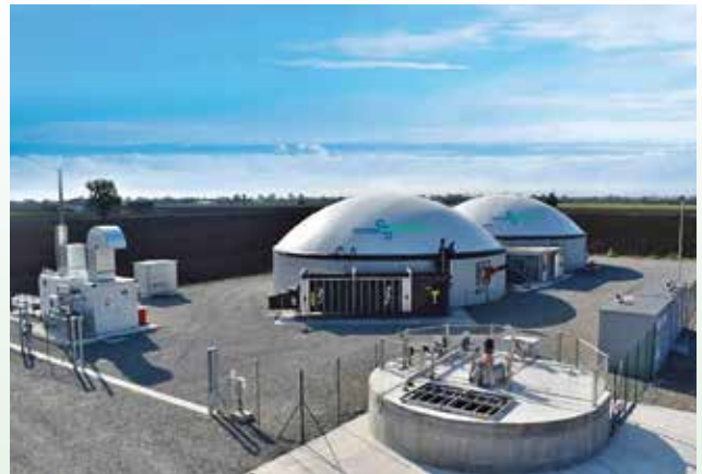
Cogenerazione a biogas/biometano
